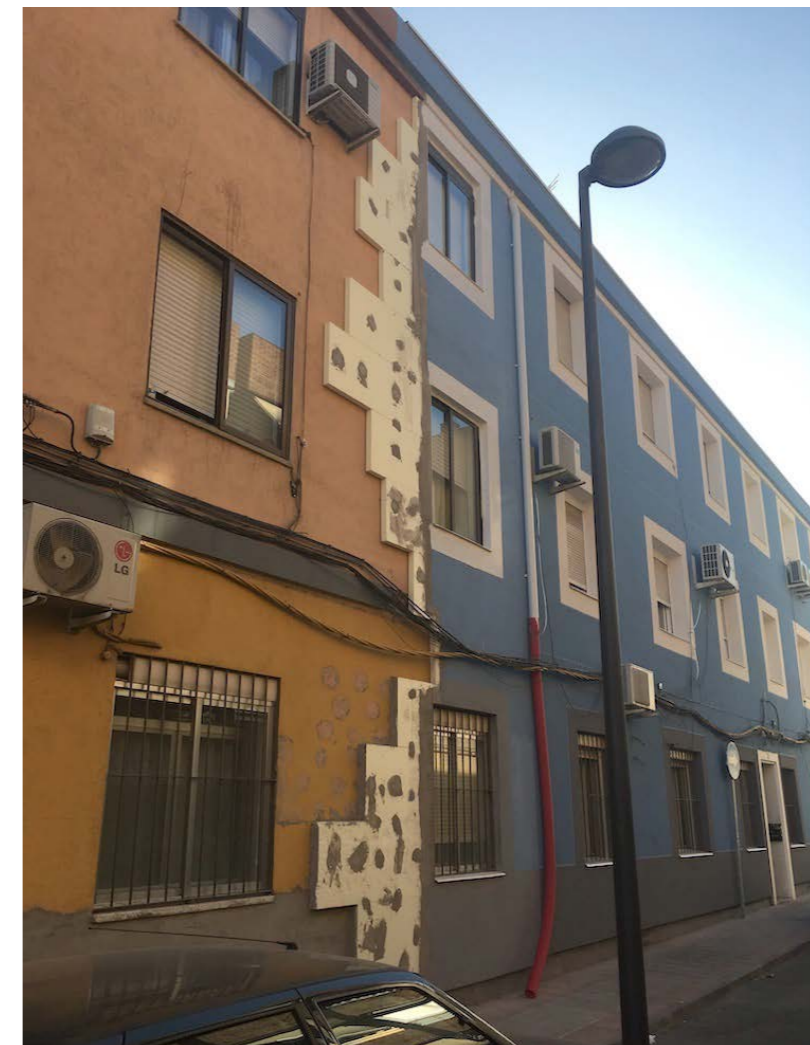
Fig. 17. Sistema SATE aplicado durante la rehabilitación de un edificio de viviendas. Izquierda: estado sin rehabilitar. Derecha: estado rehabilitado.
